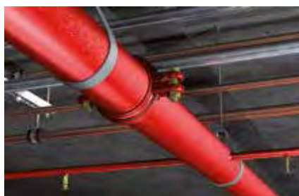
Sistemas contra incendio
